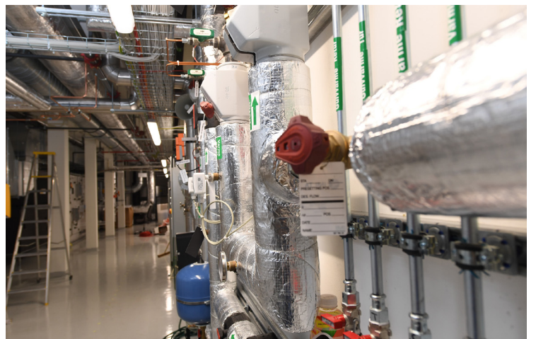
Teknisk rom: mye teknologi må til for å drive et moderne sykehus. Foto: Bernt Nilsen
